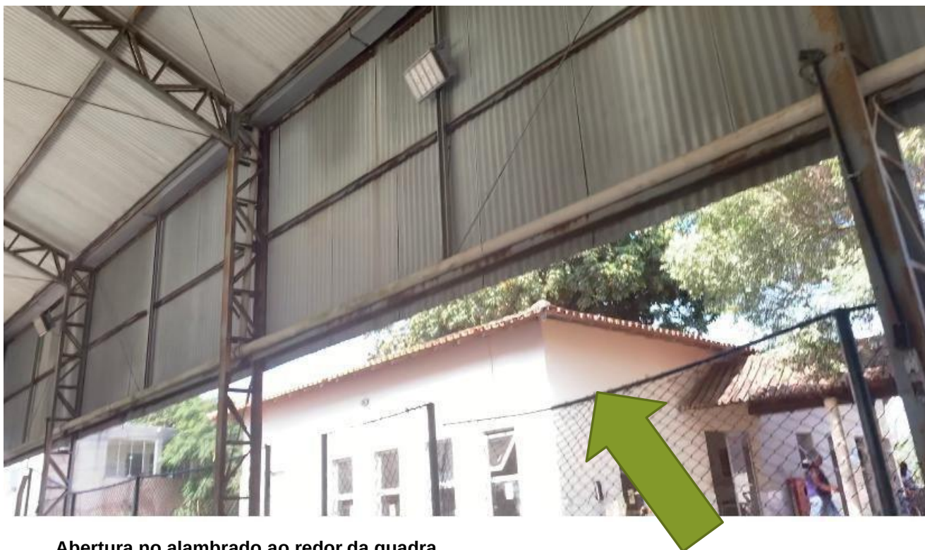
Abertura no alambrado ao redor da quadra
