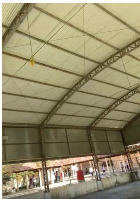
Tirante em estado avançado de oxidação
