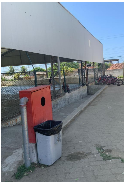
Rampa de acesso a quadra sem beiral de proteção causando escoamento da água da chuva.
