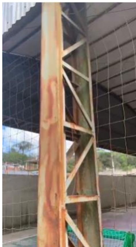
Oxidação uniforme presente nas peças
