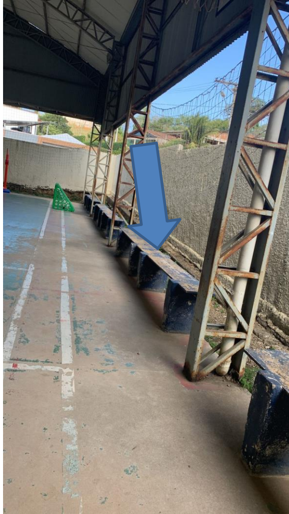
Banco de concreto desgastado com o tempo .
