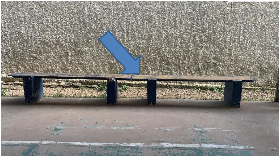
Banco de concreto desgastado com o tempo
