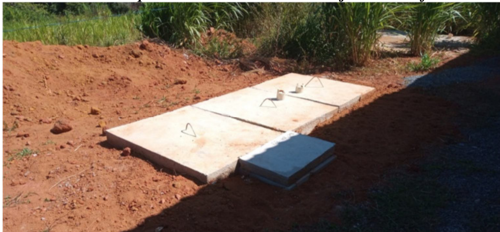
Vista do STED que atende ao sanitário do alojamento / refeitório.
