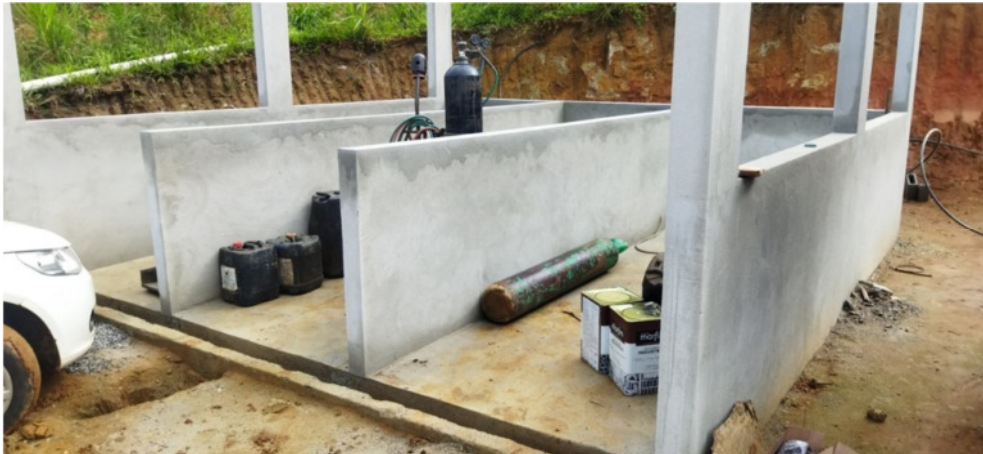
Vista da unidade 04, onde são desenvolvidas pequenas manutenções de equipamentos e o armazenamento de resíduos sólidos.
