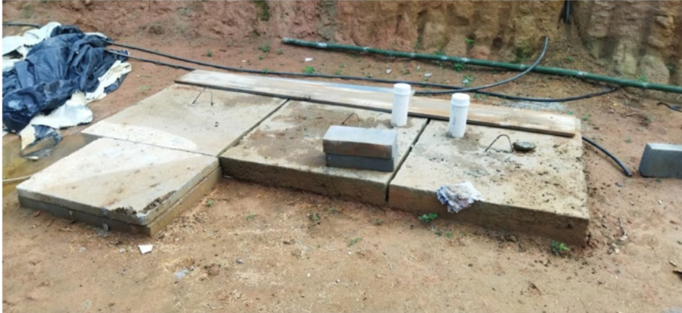
Vista do STED que atende ao sanitário existente no escritório.
