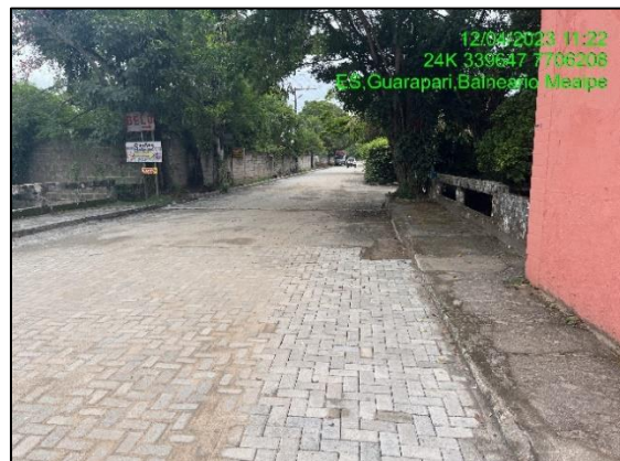
Figura 50: Calçada fora de padrão e interrompida por árvore.
