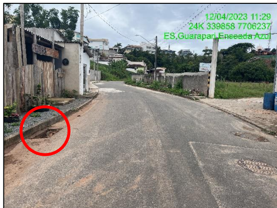
Figura 54: Dispositivo de drenagem na rua Gilda Leal.
