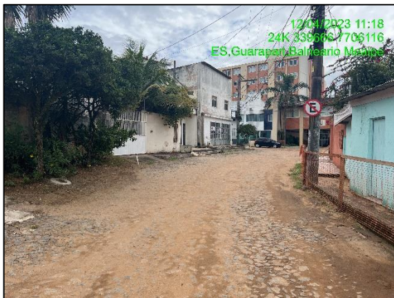
Figura 43: Calçadas descontinuadas, sem pavimentação, desniveladas e com vegetação.
