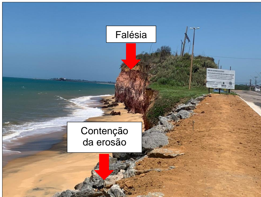
Foto 5: Litoral de Meaípe, ao fundo a formação de falésias e parte da obra de contenção da erosão.
