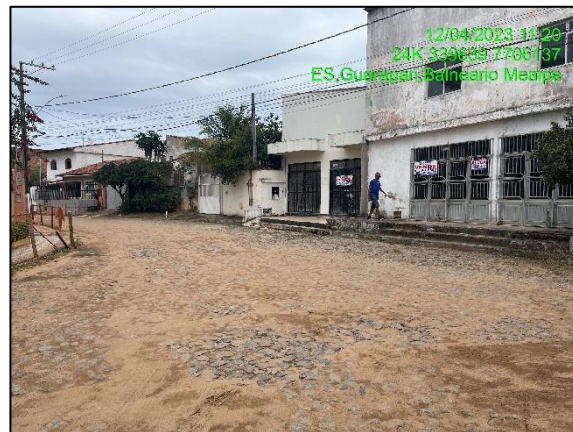
Figura 44: Calçadas descontinuadas e desniveladas.
