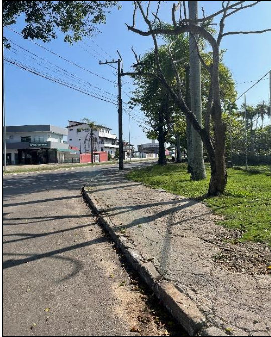
Figura 50: calçada degradada na Av. Meaípe.
