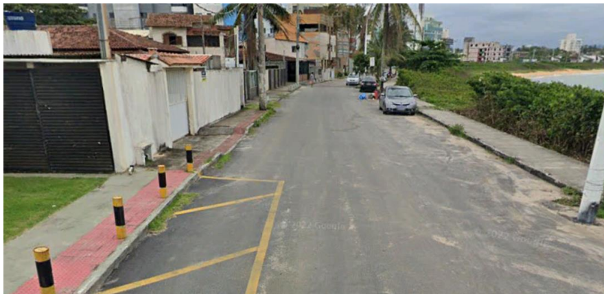
Figura 50 – Inexistência de calçada cidadã.
