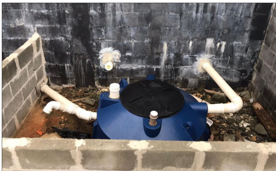
Figura 54: Biodigestor instalado no empreendimento.
